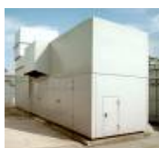
非常用発電装置
