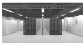
エコ空調システムに対応したラック
