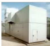
非常用発電装置
